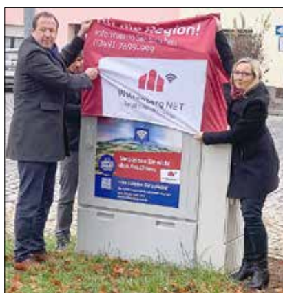
Inbetriebnahme des Breitbandnetzes der wittenberg-net im Stadtgebiet.
