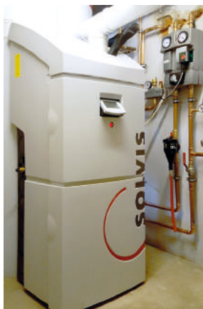
Abb. 12-17 Gas-Brennwert-Kessel mit Solarspeicher
