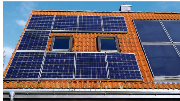
Abb. 12-22 PV-Anlage als Aufdachkonstruktion mit Lithium-Ionen-Akku
