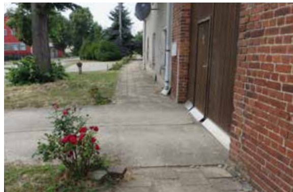
Abb. Sanierungsbedürftiger Fußweg Heinrich-Heine-Straße
