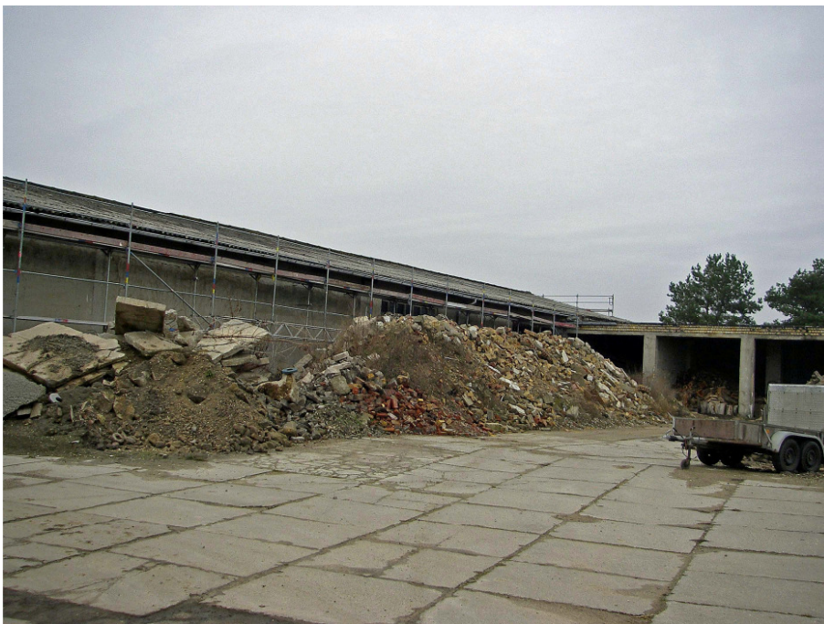
Abb. 13: Beispiel für abgelagerten Bauschutt, der durch Recycling der Wiederverwertung zugeführt werden soll, hier Nordecke vor der Mehrzweckhalle. (Foto RIK: P131216-040)
