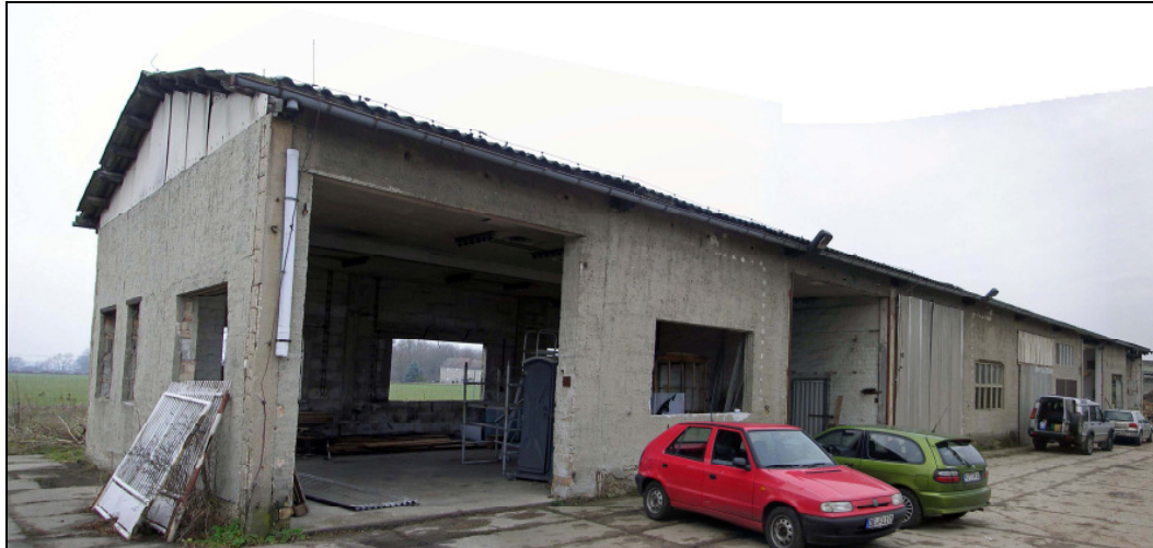
Abb. 9: Beispiel für die vorhandene Bausubstanz im Plangebiet des vorhabenbezogenen Bebauungsplanes. Die Gebäude sind alle stark physisch verschlissen. Hier Blick auf die Lagerhalle im Bau Feld 3.
